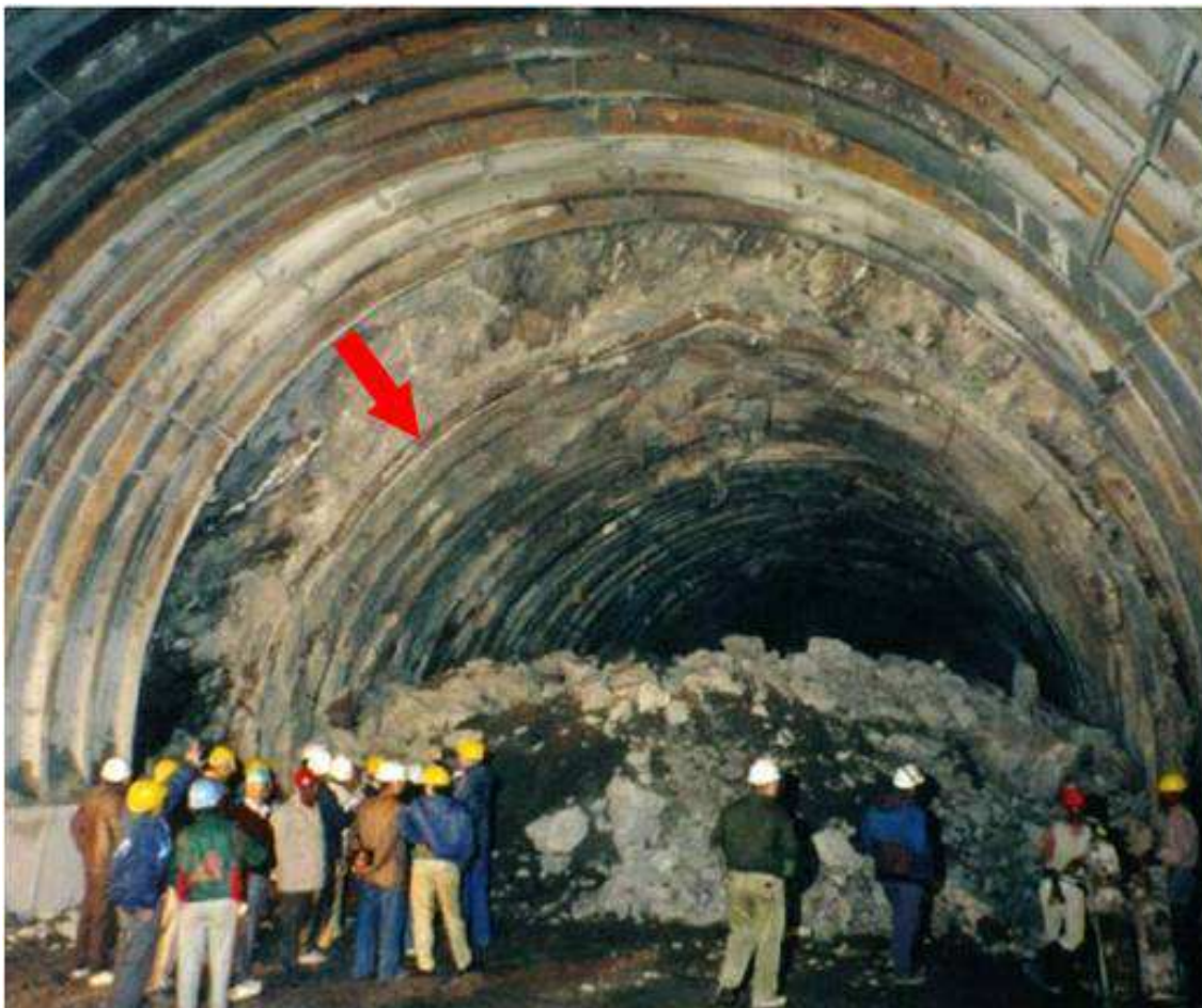
Déformation excessive observée dans un tunnel due au gonflement
