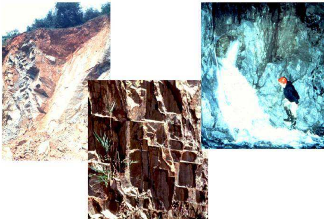
Problèmes typiques associés avec les joints rocheux
