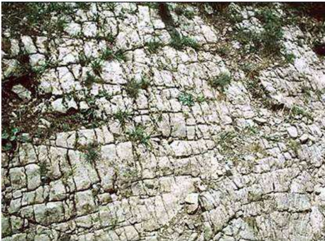
Exemple de joints (deux ensembles dominants)
