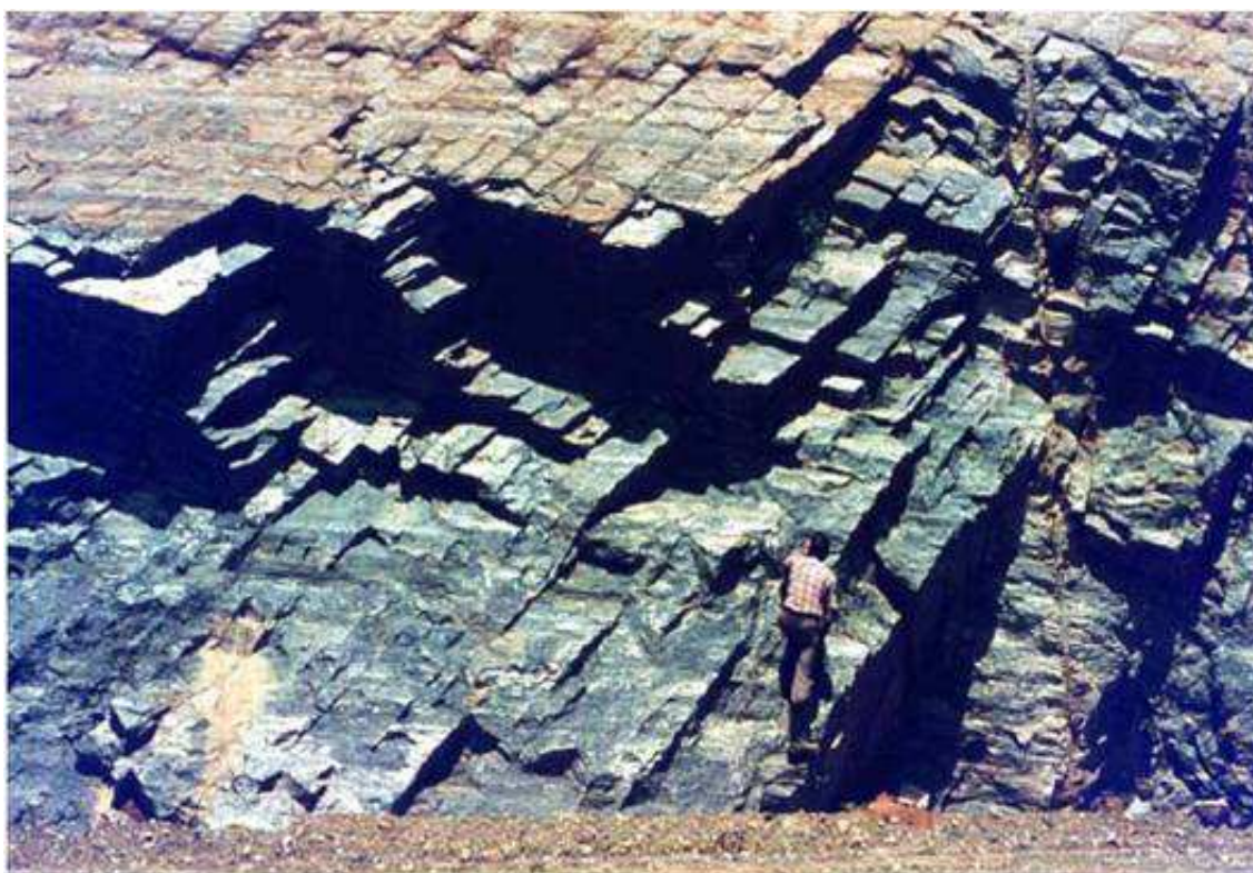
Exemple de joints observés (un ensemble dominant)
