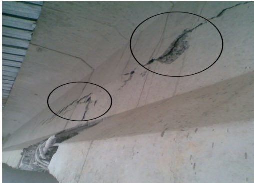
Figure 3: Les épaufrures causées par le choc.
