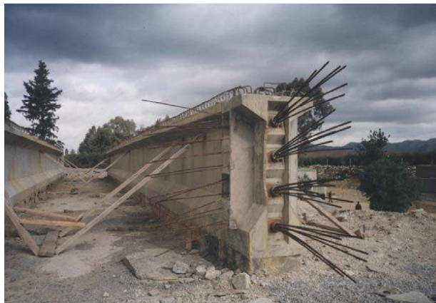
Exemple d'une poutre préfabriquée sur place avec 4 câbles de la première famille
