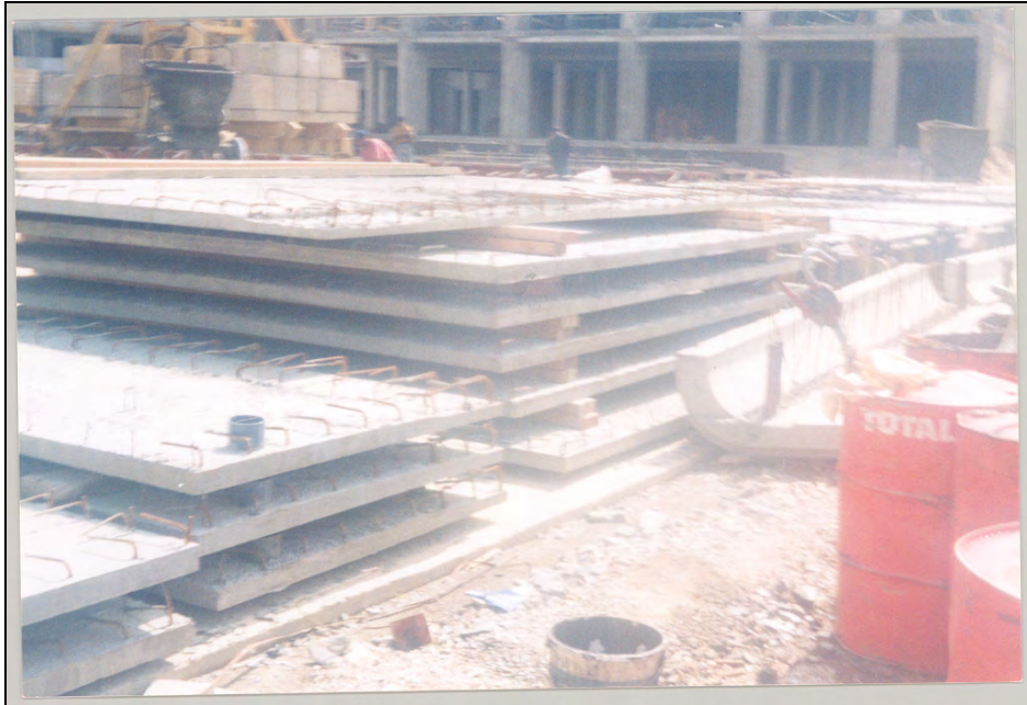
Fig.10 :Stockage des panneaux.
