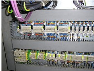
Connexions dans une armoire d'automate
